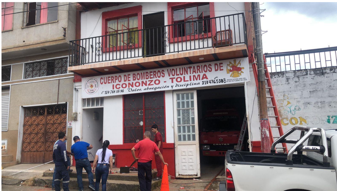
Estación de Bomberos Icononzo – Instalación radios.
