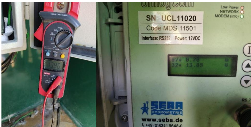
Ilustración 41: Voltaje de batería y medición de sensores.
