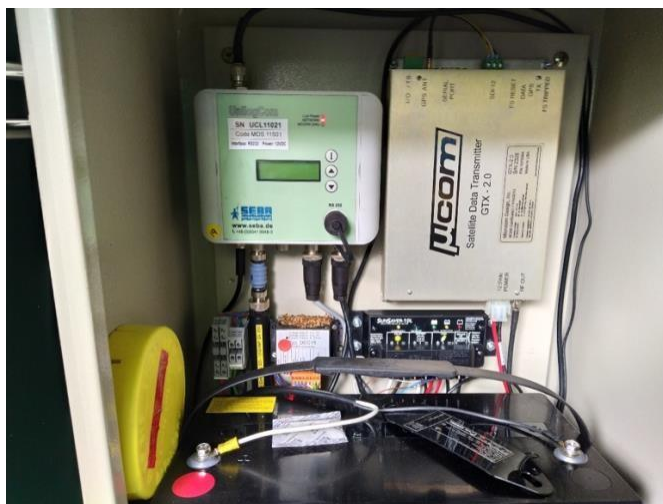
Ilustración 22: equipos de telemetría
