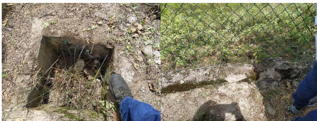
Ilustración 72: Caja de inspección sin caja y cerramiento deteriorado
