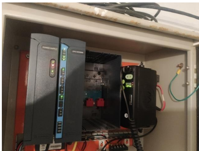
Ilustración 99: Sistema encendido y con comunicaciones.
