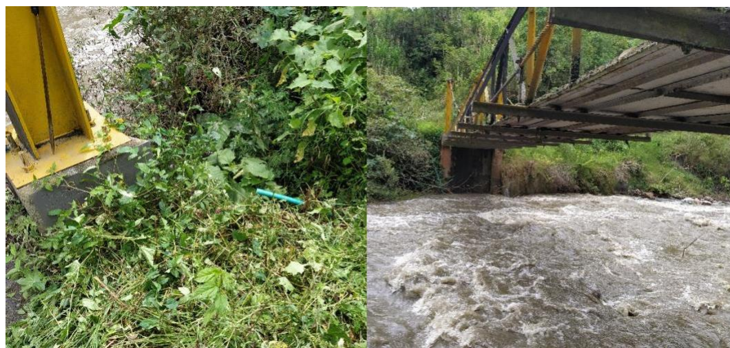
Ilustración 21: Tubo PVC de sensor de nivel y puente donde estaba ubicado.
