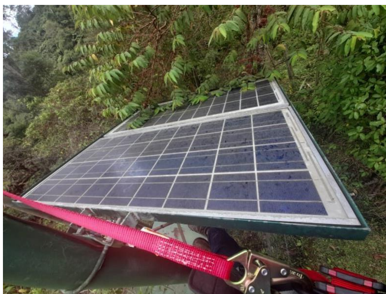
Ilustración 10: Paneles solares sucios.
