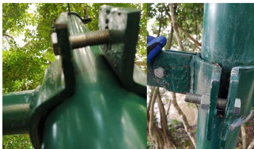
Ilustración 71: Mástil de sensor de nivel
