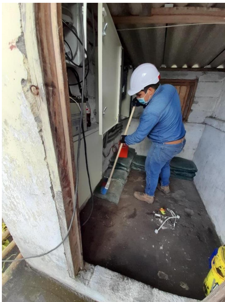
Ilustración 82: Mantenimiento de la estación.
