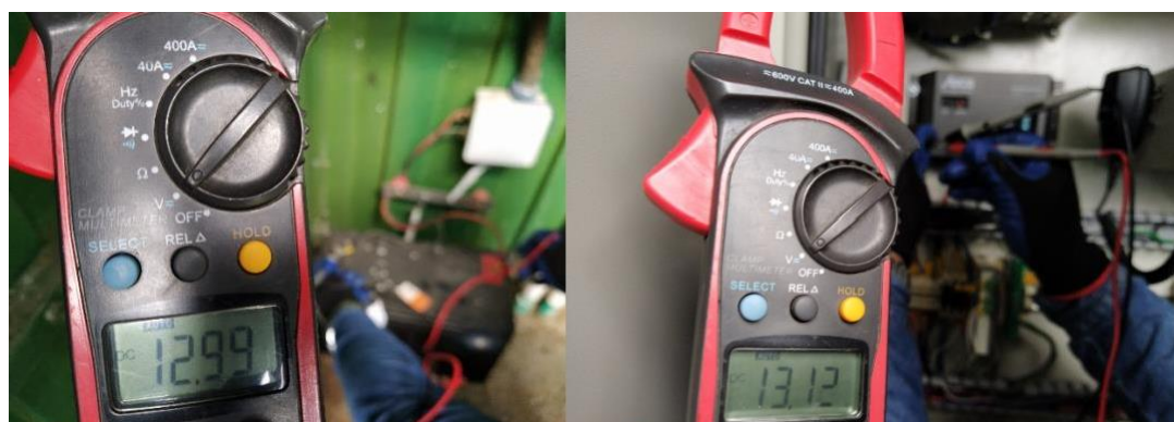
Ilustración 5: Voltaje de batería y paneles.
