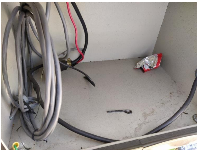
Ilustración 63: Cable de sensor de nivel y pluviómetro
