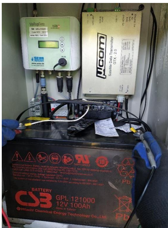
Ilustración 40: equipos de telemetría
