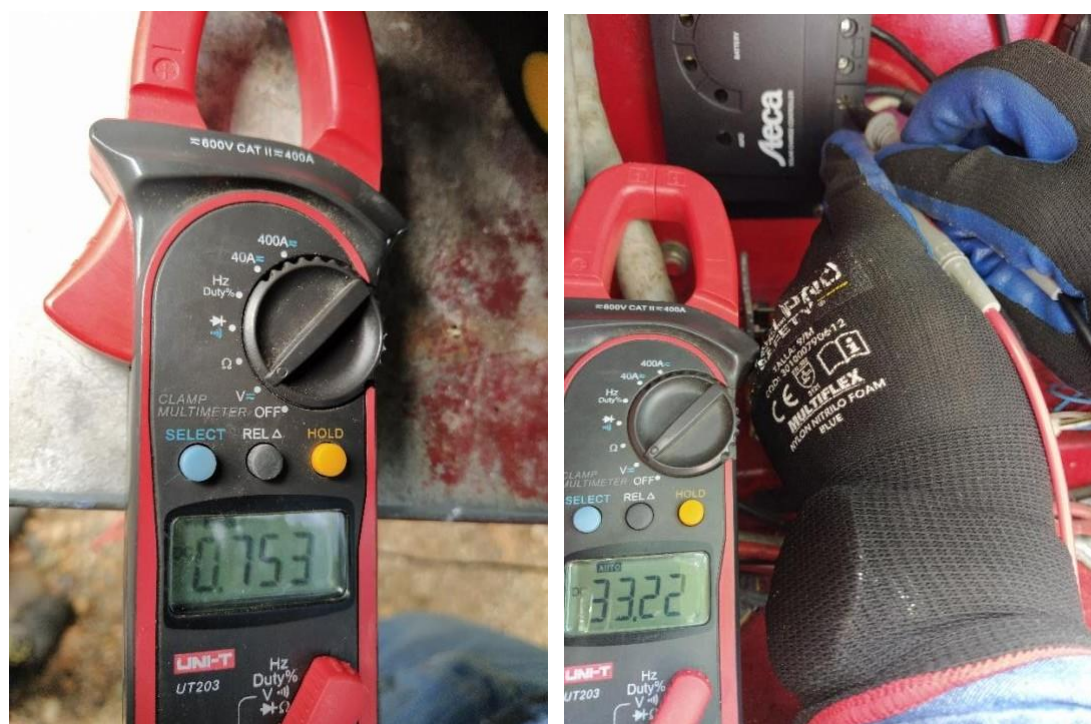
Ilustración 52: Voltaje de batería y paneles solares
