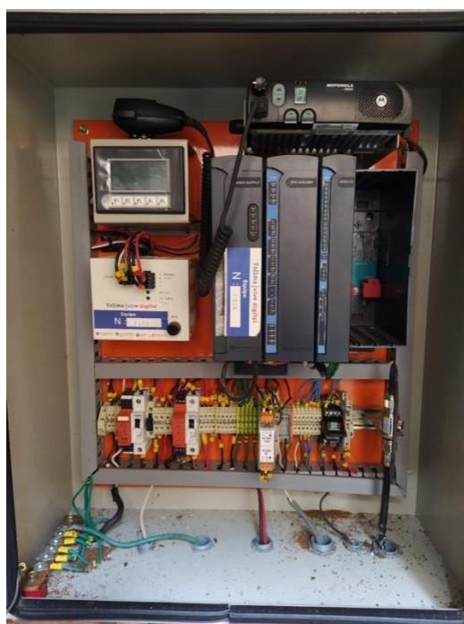
Ilustración 47: Elementos de telemetría
