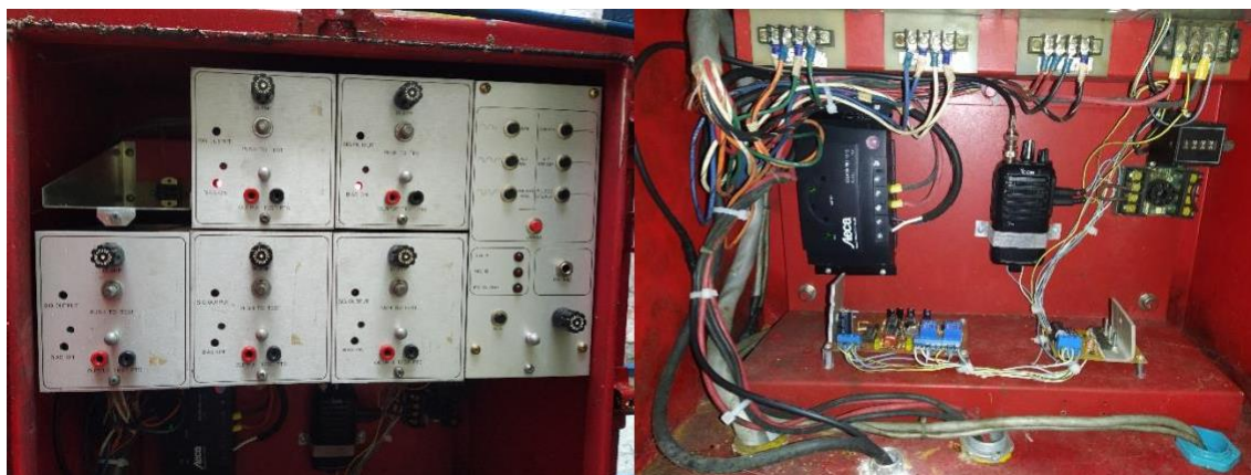
Ilustración 60: Sistema de amplificación, regulador solar y mezclador de sonido
