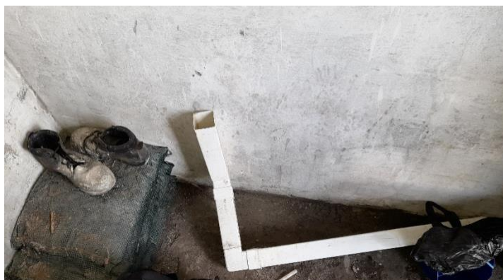
Ilustración 81: Elementos ajenos a la estación.
