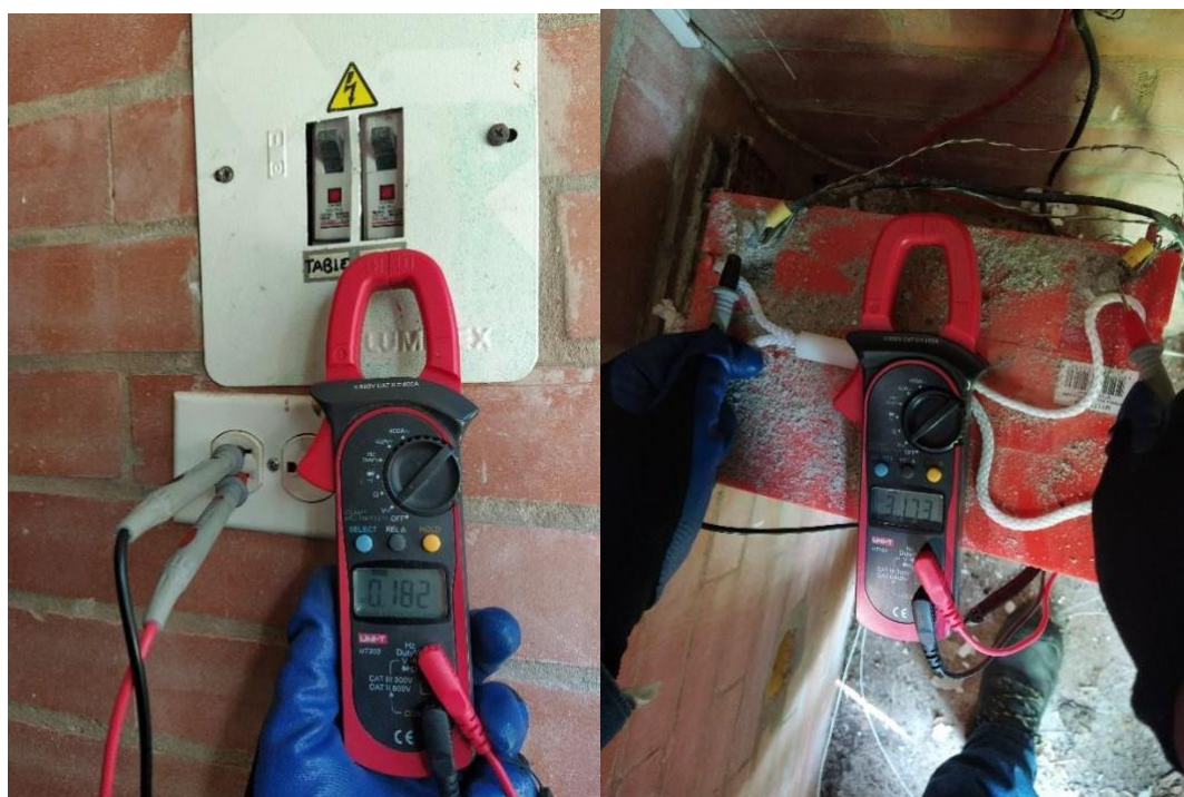
Ilustración 75: Estación sin energía eléctrica y medición de batería descargada.
