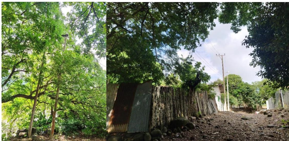
Ilustración 49: Ubicación del transformador y acometida del transformador
