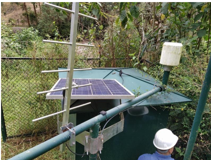
Ilustración 25: Estructura y paneles solares
