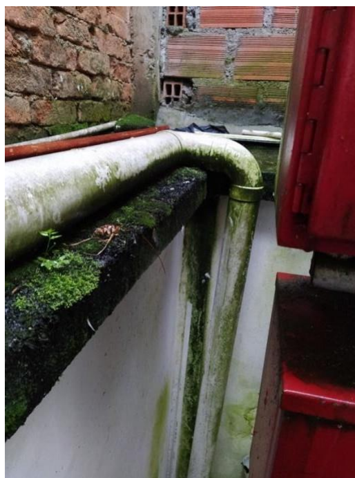
Ilustración 59: Presencia de musgo y humedad
