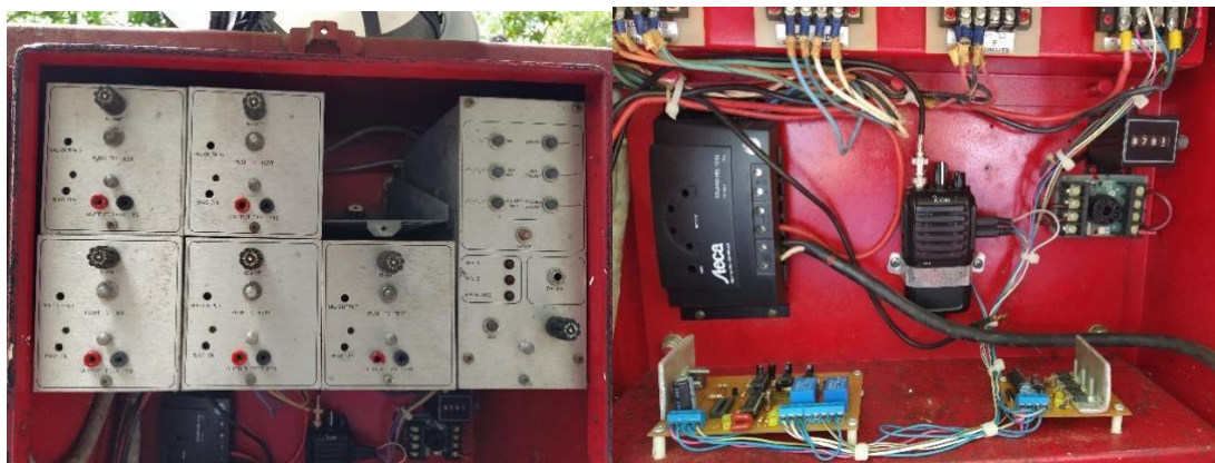
Ilustración 51: Etapa de potencia, comunicaciones y control
