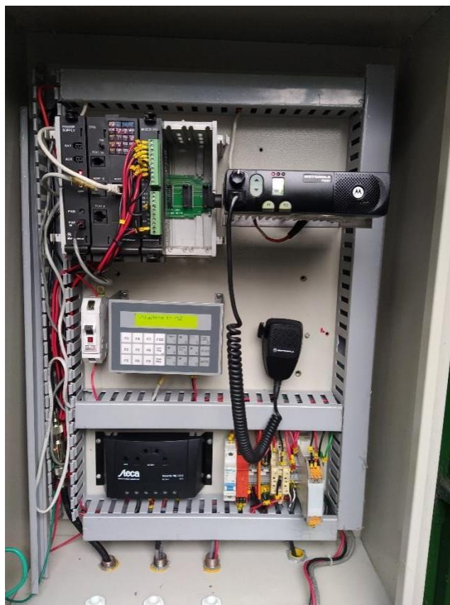
Ilustración 32: Elementos de telemetría de la estación
