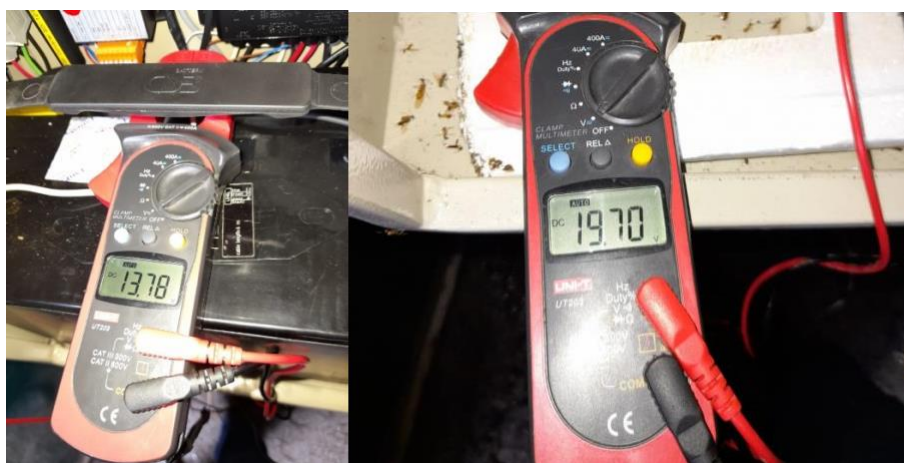
Ilustración 23: Voltaje de batería y paneles solares.
