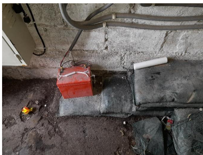
Ilustración 80: Bateria mal ubicada.
