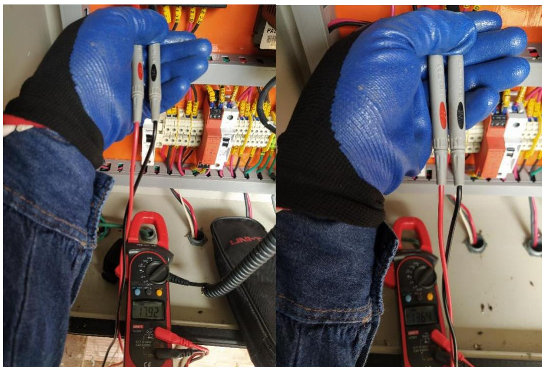
Ilustración 70: Voltaje de paneles y de batería
