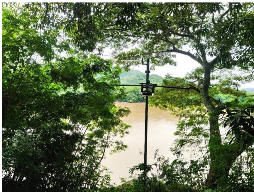
Ilustración 46: Ubicación del sensor de nivel
