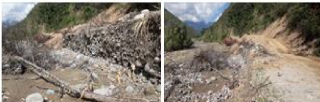
Fotos No 1 y 2 Socavación lateral de fondo y sedimentación del centro del cauce, lo cual ha formado un brazo
