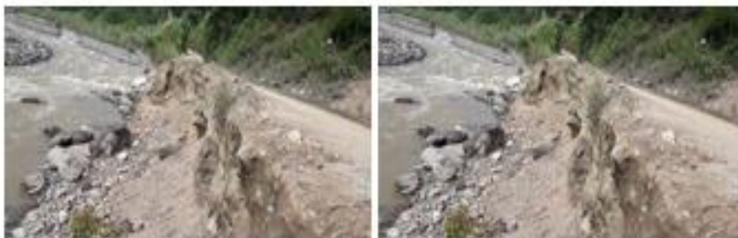
Fotos No 3, 4 Socavación lateral del talud y afectación de la banca de la vía (antes)
